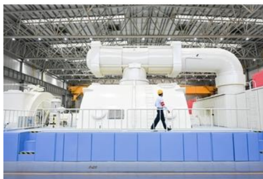
图：南沙电力公司生产现场
