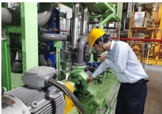
图：操作员日常巡检
