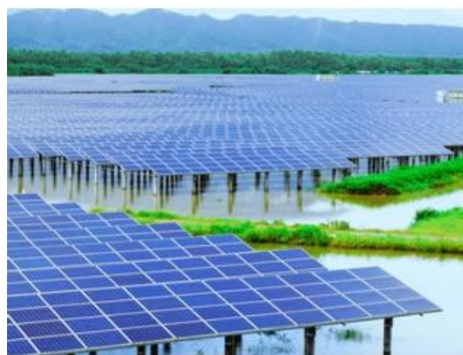
台山渔光互补光伏项目
