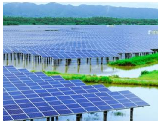
台山渔光互补光伏项目
